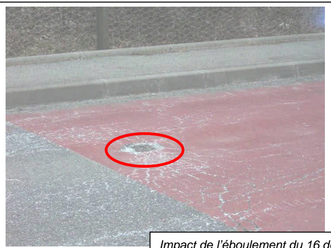
Impact de l'éboulement du 16 décembre 1995 sur la RD 1075
